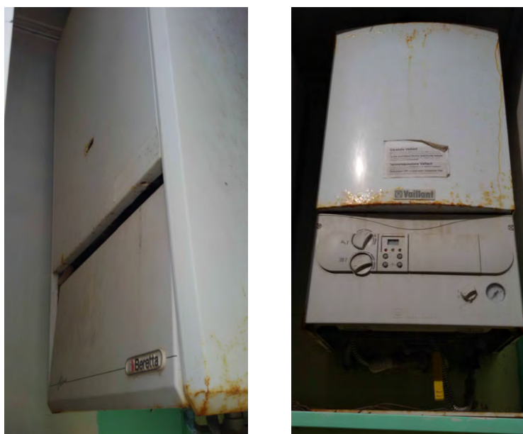
Caldaie murali esistenti
